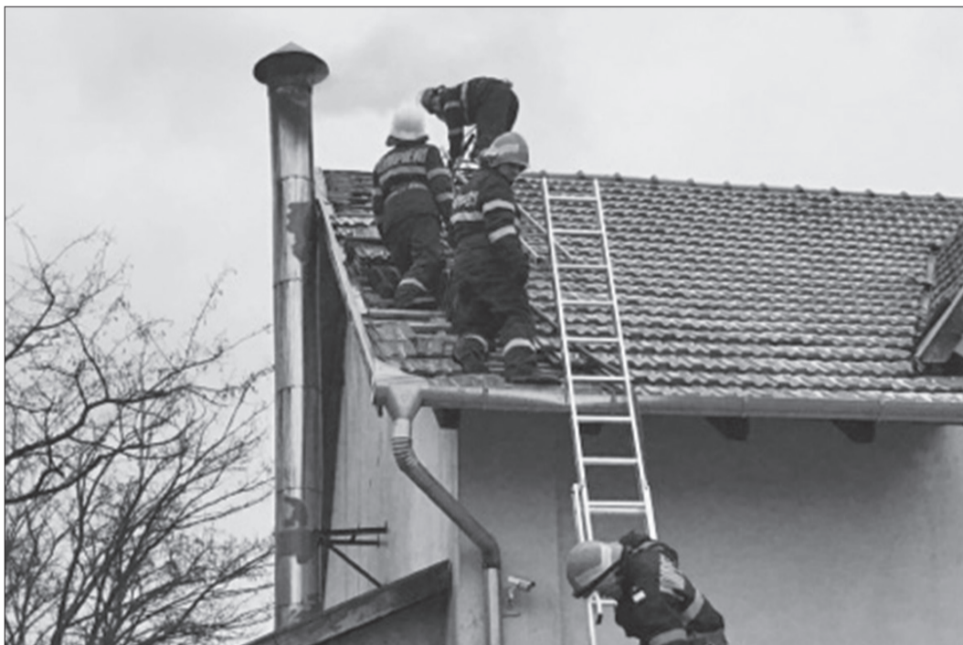
Întreținerea coșurilor de fum este vitală pentru siguranța clădirilor
